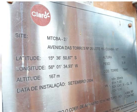
Imagem 04. Detalhes da ERB Claro. Foto: Danilo Bertoloto. Data: 20/03/2018. Av. das Torres.
