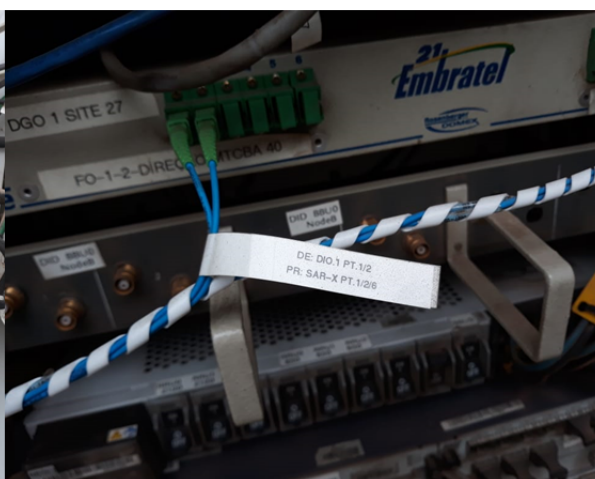
Imagem 07. Link de fibra óptica da Embratel. Foto: Danilo Bertoloto. Data: 20/03/2018. Av. Das Torres, Cuiabá.
