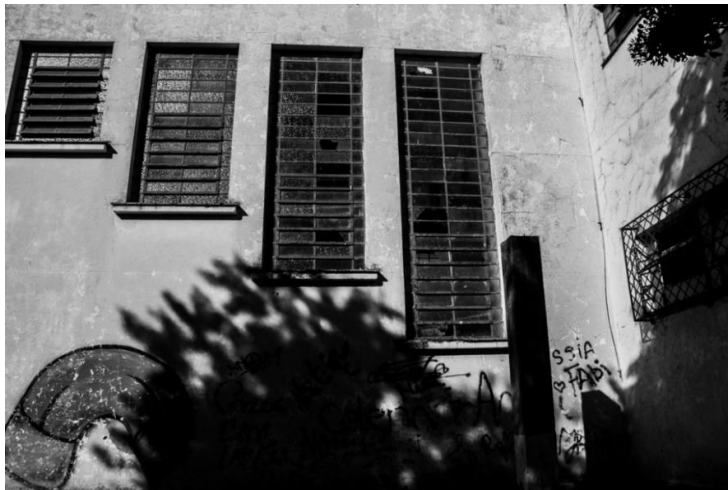
Figura nº 05: Janelas quebradas – registro dos alunos.
